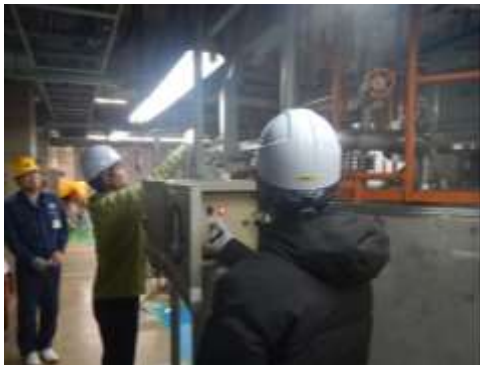
図 3.2-18 ポンプ・弁操作
